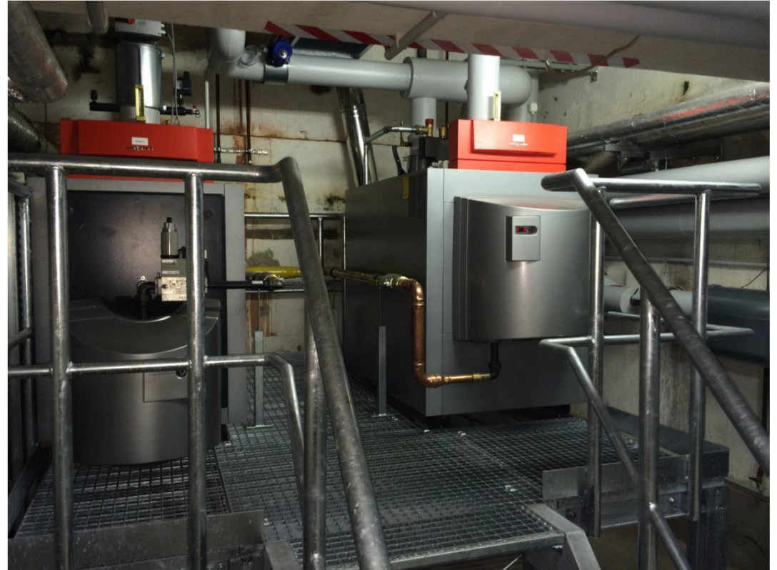
Brennwert- und NT-Kessel
