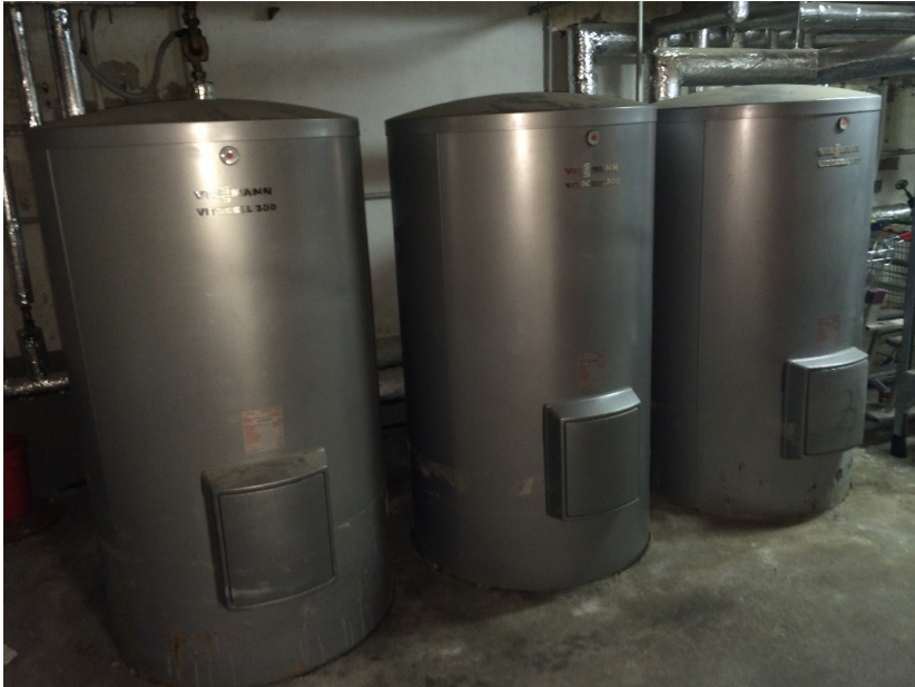
Wärmewasserbereiter 3 x 500 l
