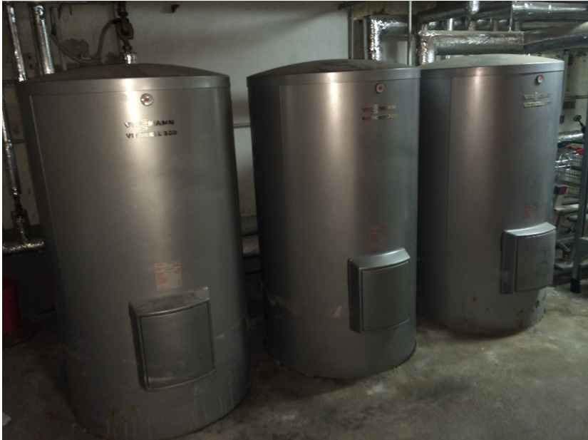
Wärmewasserbereiter 3 x 500 l
